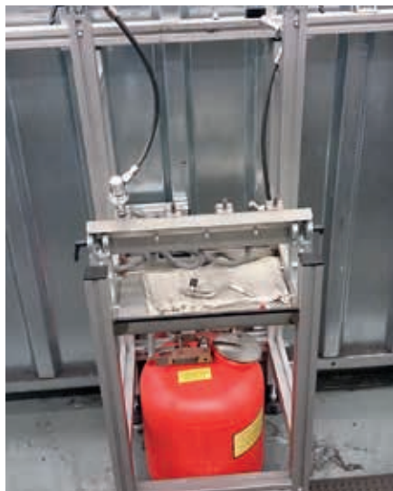
Dank dieses Auffangbehälters und der Absaugung können die Kollegen wieder normal arbeiten und atmen
