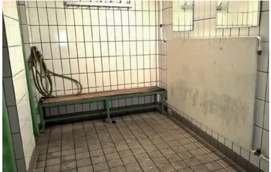
Die Böden, vor allem in den Dusch- und Sozialräumen der Warmbetriebe werden nur oberflächlich gereinigt (hier: Waschraum 53 im Gebäude 140 in der Schmiede)
