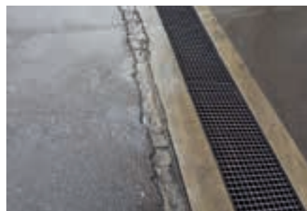
Einer von vielen Straßenschäden im Werk Untertürkheim
